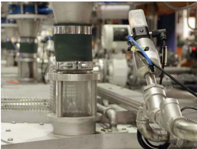
Im Vordergrund GEMÜ 550, dahinter Füllrichtung der Zentrifugen
