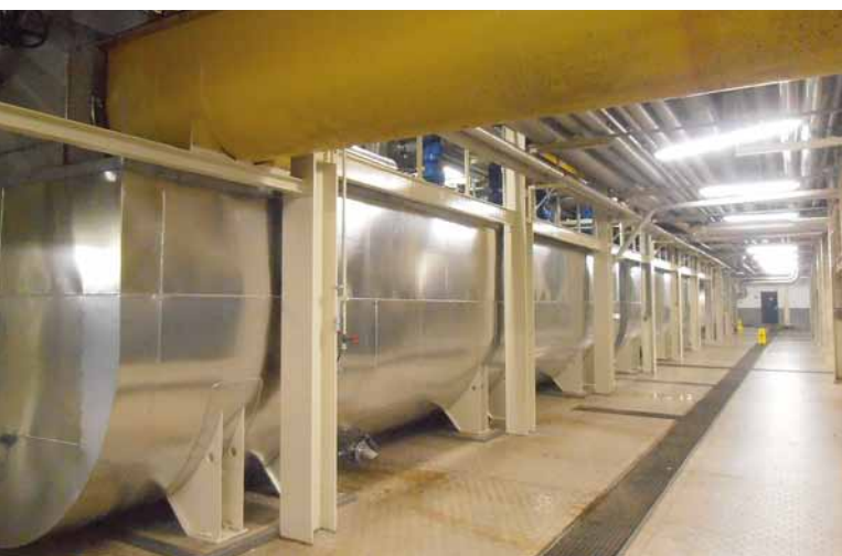
Neue Zuckerauflösung in der Zuckerfabrik Dinteloord
