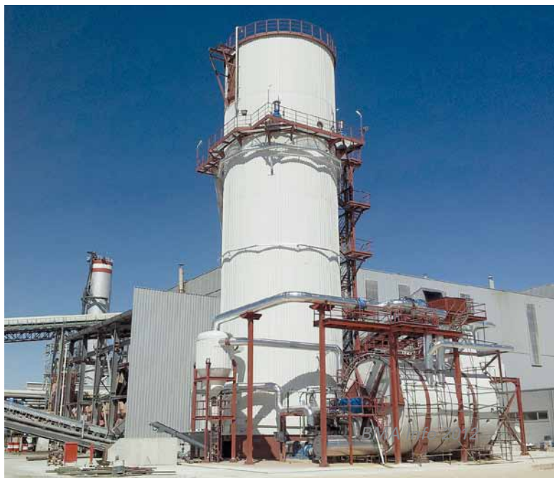
Extraktionsanlage in der Zuckerfabrik Kesinkiliç
