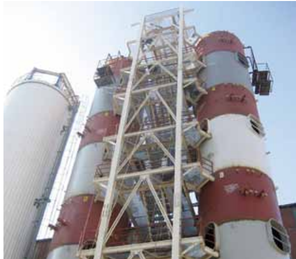
...keine Leuchttürme – Rohzucker- und Nachprodukt-VKT mit Treppenturm
