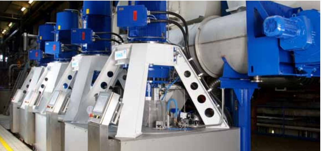
Zentrifugenstation mit neuen E1810
