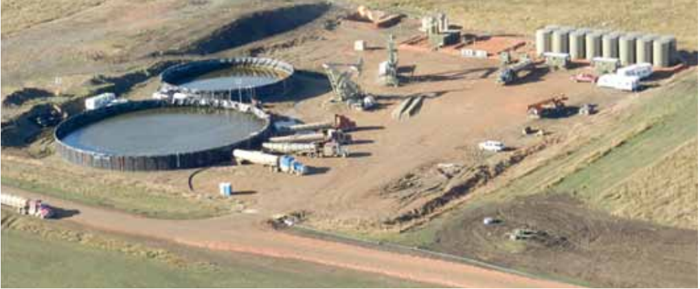
Citernes d'eau sur un puits de forage
