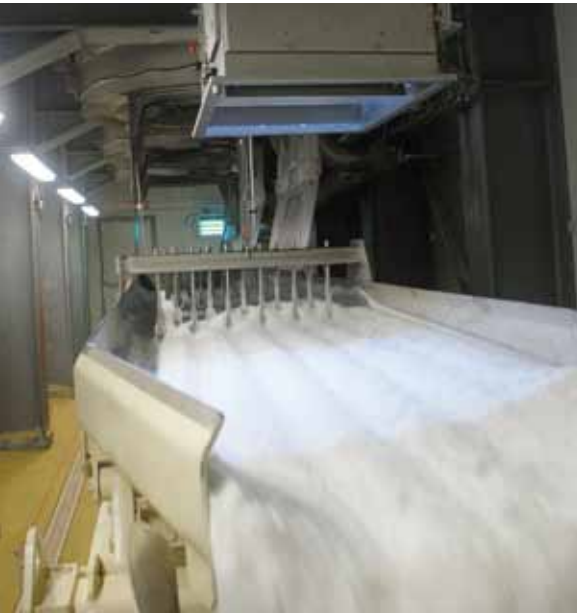
Colorimètre installé au-dessus d'un convoyeur vibrant
