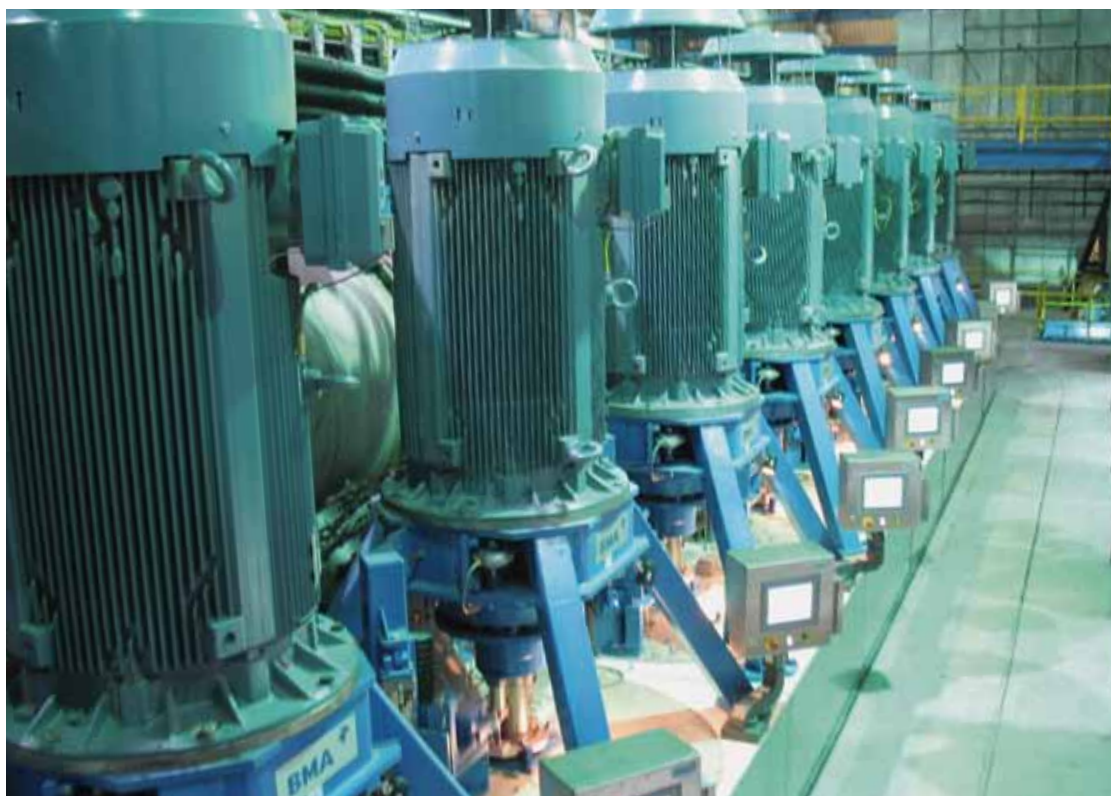
Puesta en servicio de la mayor estación de centrífugas de azúcar refinado del mundo (14 máquinas del tipo B2200 R)
