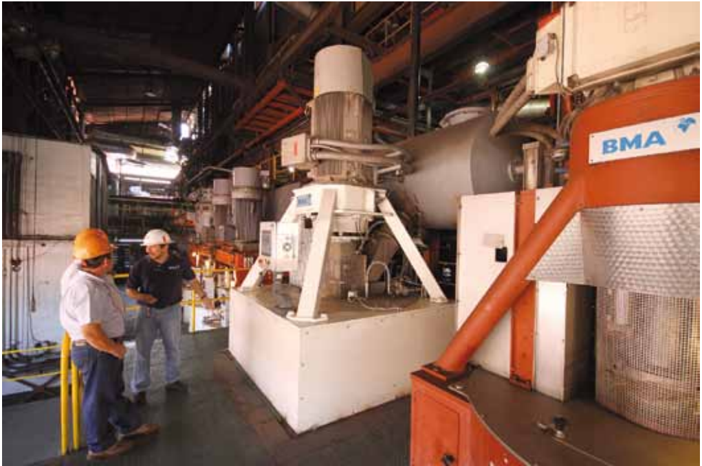
Новая высокопроизводительная центрифуга B1750 на заводе La Unión (справа: её предшественница G1750)
