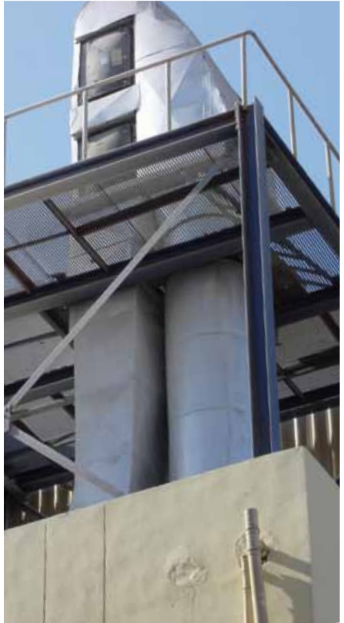
Plataforma de operación superior de la estación de hinchamiento de maíz
