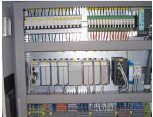
Allen-Bradley-Steuerung für Zellenradschleusen
