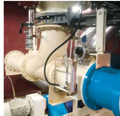
Mélangeur de massecuite avec de la mélasse
