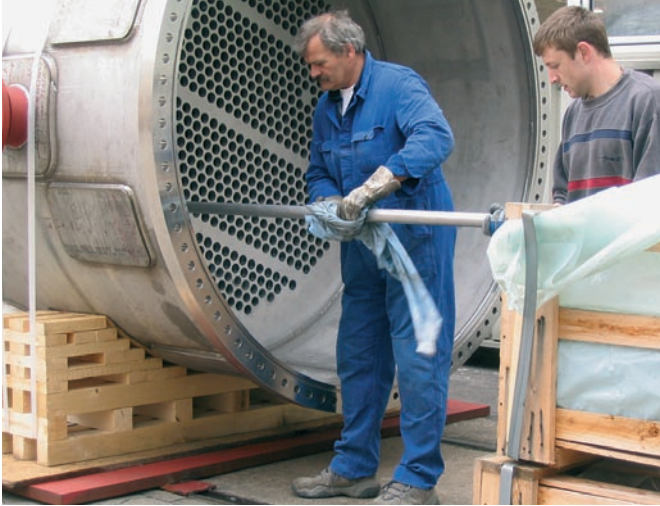
Dudgeonnage des tubes dans l'évaporateur à descentage
